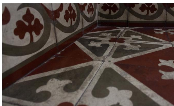
Figura 24: Piso e rodapé do salão Genesino Braga na Biblioteca Pública do Amazonas.
